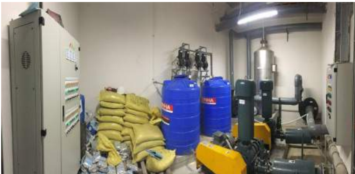
Hệ thống xử lý nước thải “Tòa nhà Sky Park Residence” Công suất 640m 3 /ngày đêm
